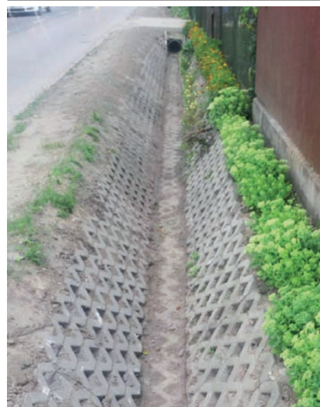
Przydrożny rów – ul. Warszawska © K. Klimaszewska
